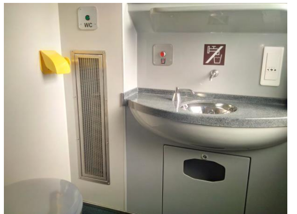
Neu eingebaute Vaccum-Toiletten wirken ebenfalls modern
